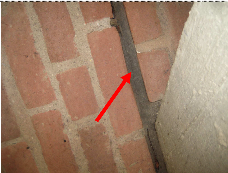
Negativfundstelle Dehnfugen Mauerwerk Stütze
