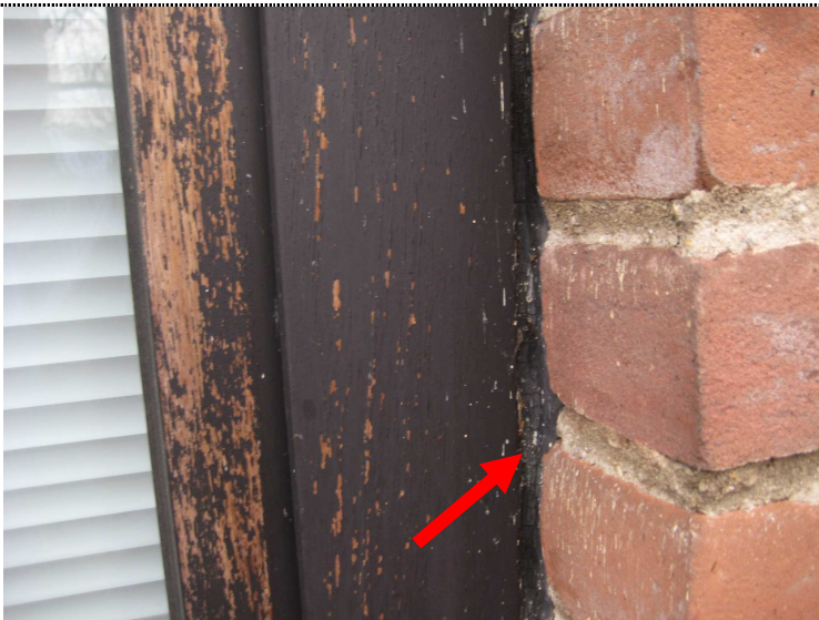
Negativfundstelle: Fugenmasse im Außenbereich
