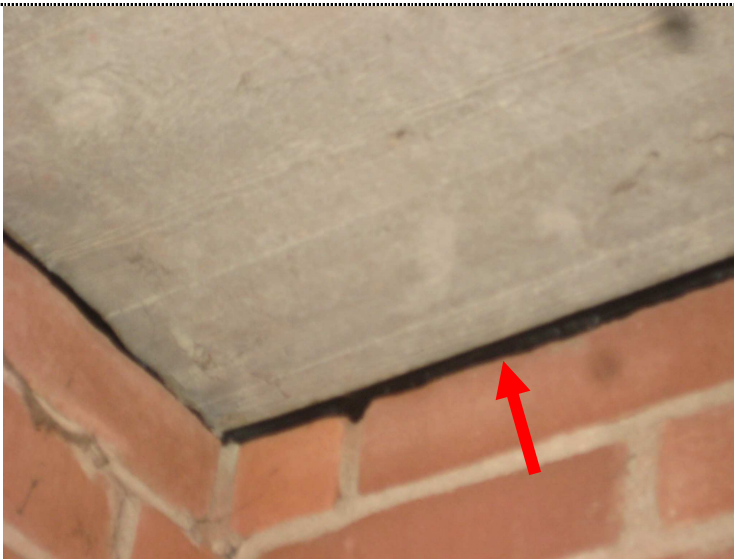
Negativfundstelle: Fugenmassen im Bereich Mauerwerk zur Decke
