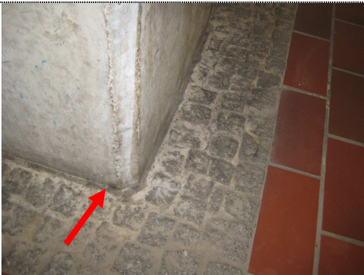
Negativfundstelle: Fugenmassen im Bereich der Betonstützen zum Boden
