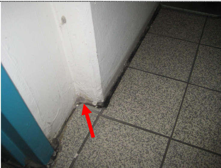
Material: Fugenmassen im Bereich Fliesen
